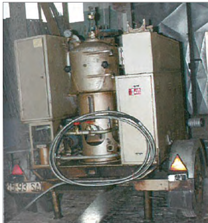
Slika 13.11 Mašina za filtriranje transformatorskog ulja, GALILEO MODEL SC 26 A512, u upotrebi od 1960-ih godina
