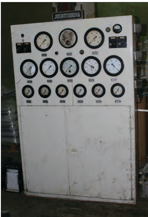
Slika 13.10 Instrument tabla pred turbinom za praćenje rada turbine 32 MW (proizvodnja 1956)
