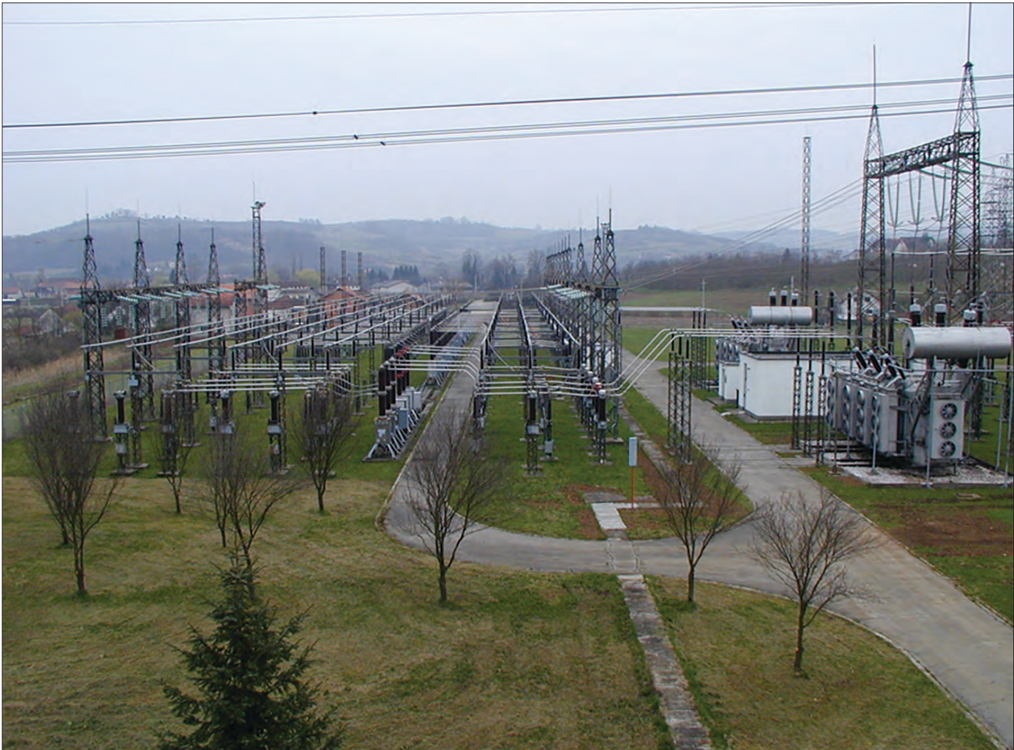
Slika 2.26 TS 400/110 kV Banja Luka 6
