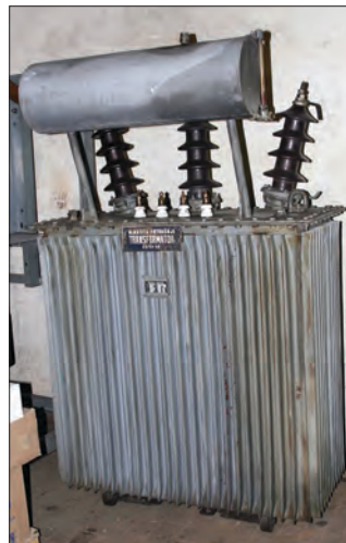
Slika 13.13 Transformator 35/04 kV (proizvodnja 1956. RADE KONČAR)
