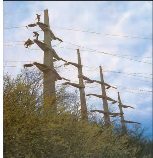
Slika 2.15 Dalekovod 110 kV sa betonskim stubovima
