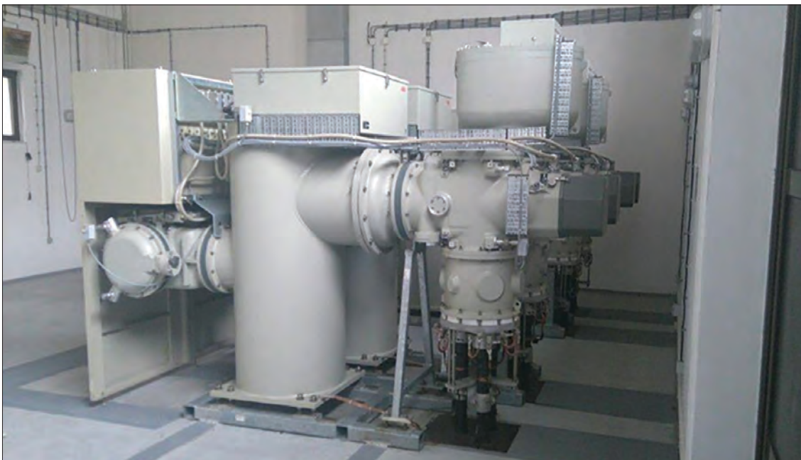
Slika 2.28 Metalom oklopljeno SF6 postrojenje 110 kV, Sarajevo 11
