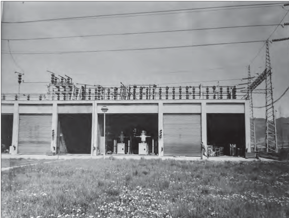
Slika 3.14 Energoinvestova laboratorija velike snage, c) srednjenaponsko postrojenje, 1985.
